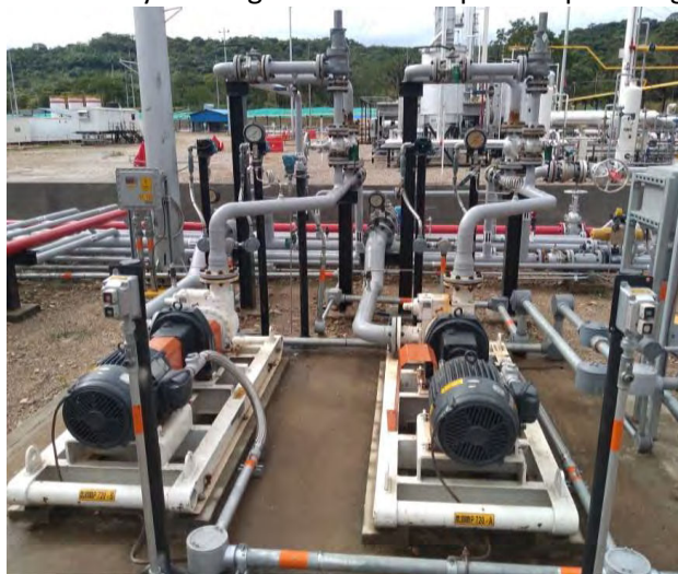
Figura 3. Bombas de despacho de GLP
