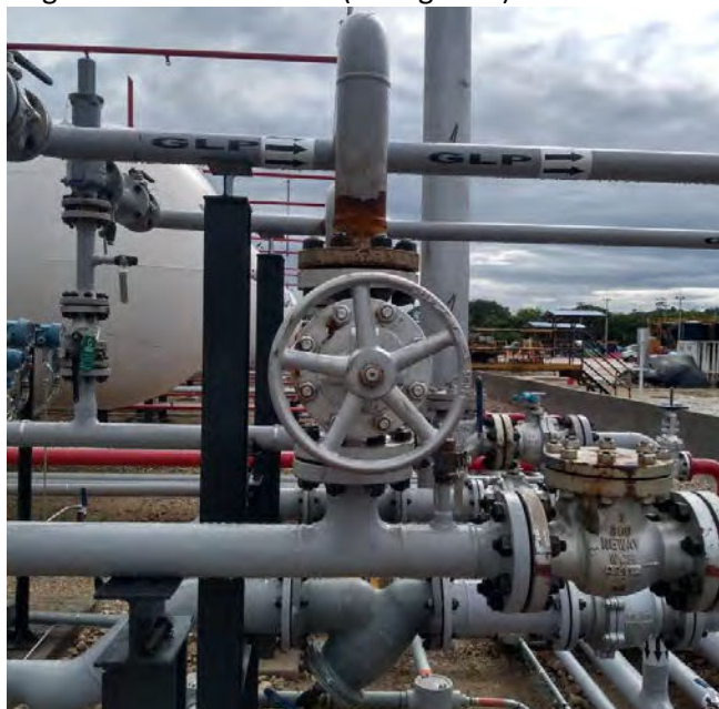
Figura 5. Válvula de recirculación.
