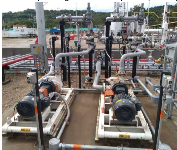
Figura 3. Bombas de despacho de GLP
