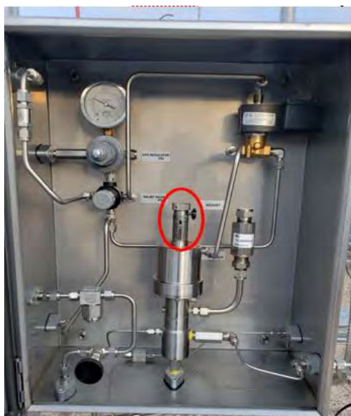
Figura 7. Sistema de dosificación de mercaptano
