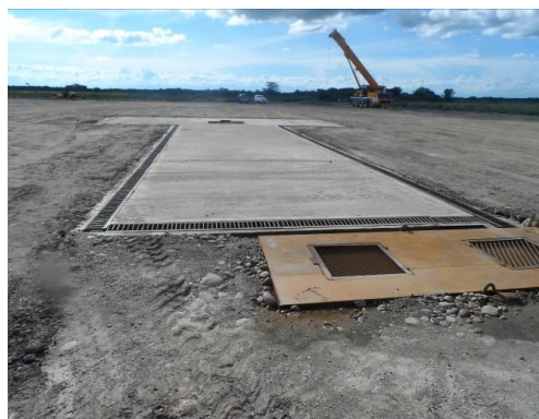
Fotografía 2- 37 Vista placa del taladro (Carrier)
