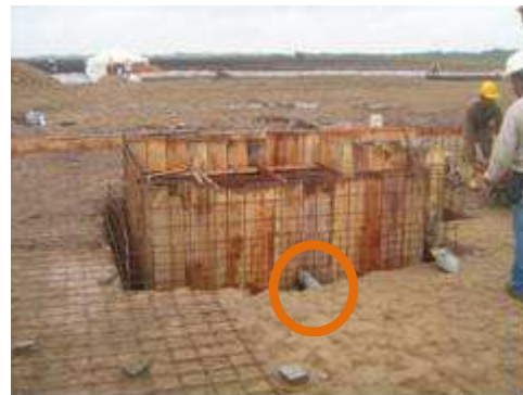
Fotografía 2. 6. Instalación de formaleta y refuerzo metálico de cellar y placa para fundir monolíticamente.
