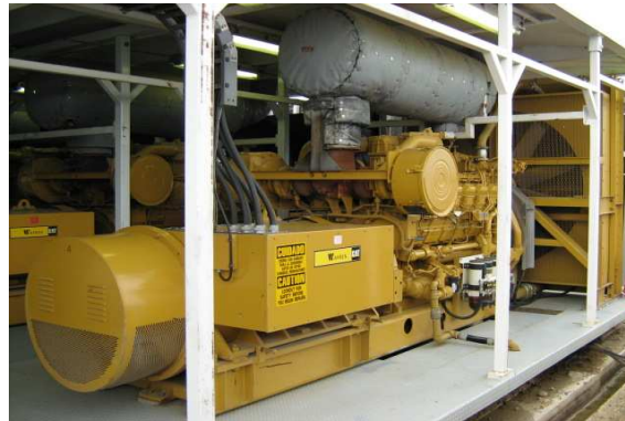
Fotografía 2. 30 Generadores de Potencia
