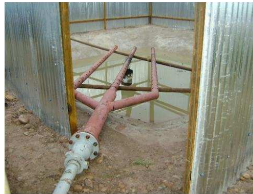
Fotografía 2. 40 Quemador con mampara de protección
