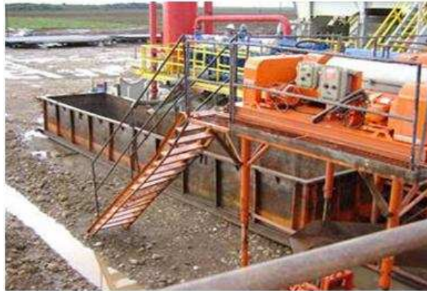
Fotografía 2. 34 Equipo del Sistema de Control de Sólidos
