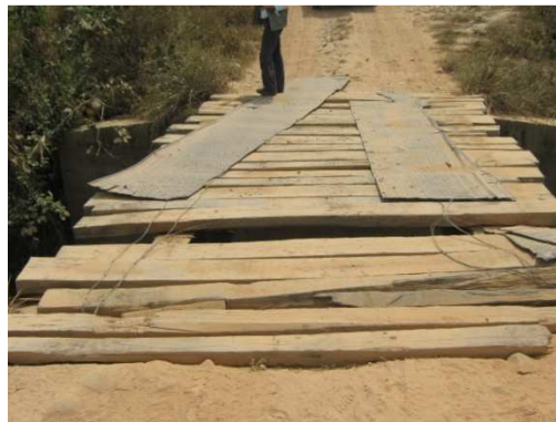
Fotografía 2. 1. Estructura del box culvert incompleta presente en la vía de acceso a la vereda Los Mangos E 1.113.763 N 968.667
